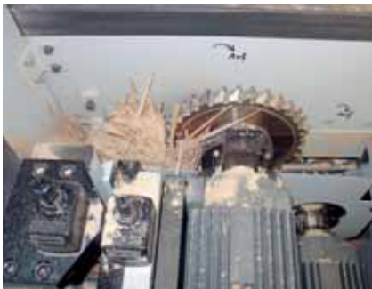
Afgebroken splinters verstoppen de afzuigmond – brandgevaar door wrijving van het roterende gereedschap!
